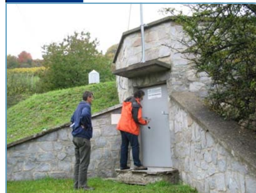
Posodobitev popisa in poročanja črpalnih objektov bo omogočila boljši nadzor nad omrežjem
