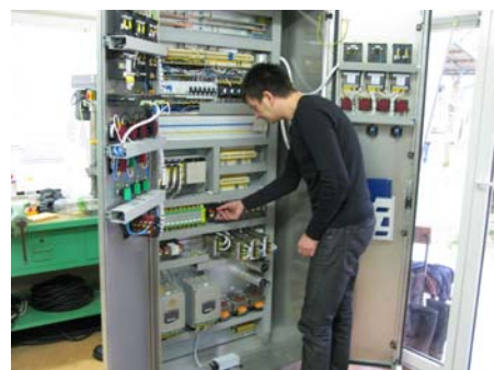
Preizkušanje elektro omare za enega od novih objektov, ki bodo vključeni v sistem
