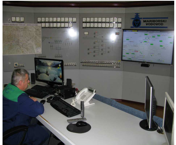
Center nadzora in vodenja vodooskrbnega sistema Mariborskega vodovoda
