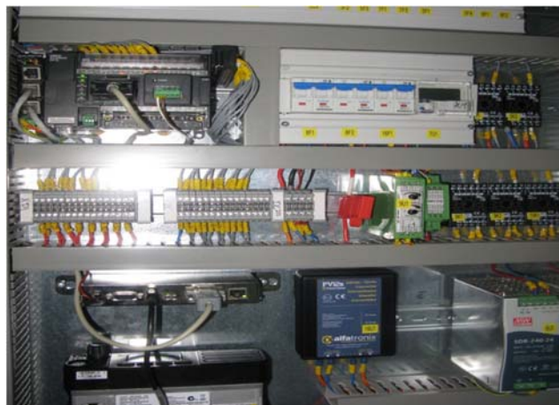
Rekonstruirana elektro oprema vodohrana
