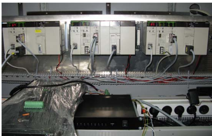
Komunikacijski krmilniki za povezavo vodooskrbnih objektov z centrom vodenja
