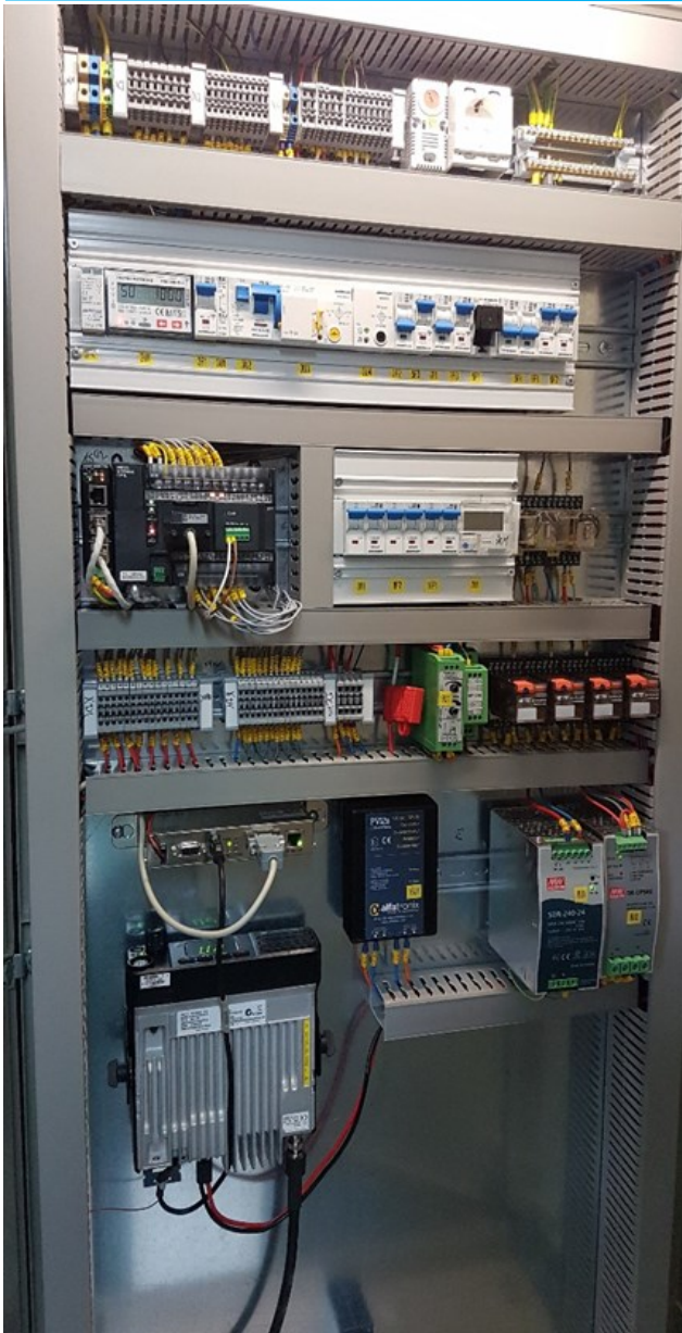
Sodobno prenovljena krmilna omara.
