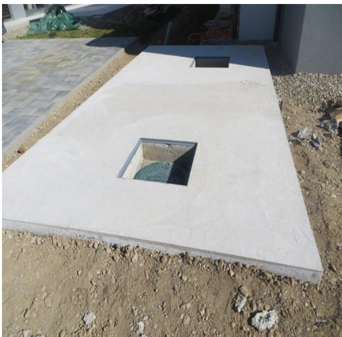
Hišni priključek, ki ni v skladu s Tehničnim pravilnikom.
