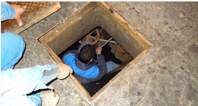
Nič kaj prijetno opravilo v takšnem jašku, sredi Partizanske ceste.
